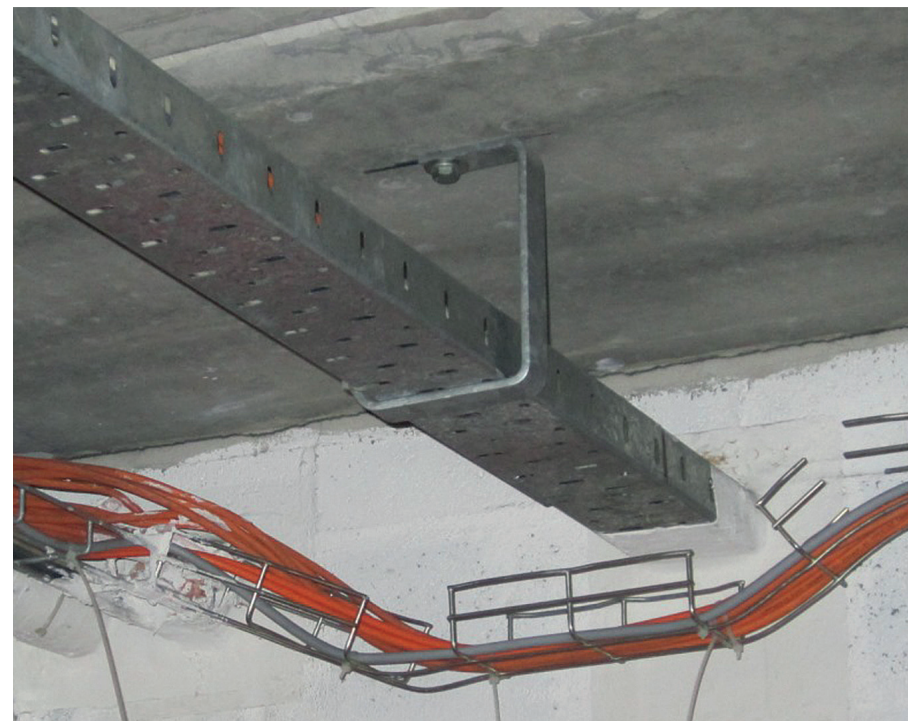
Chemins de câbles
