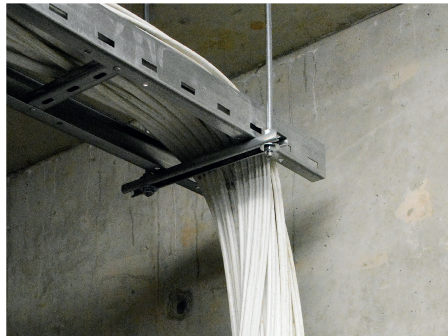
Échelles à câbles
